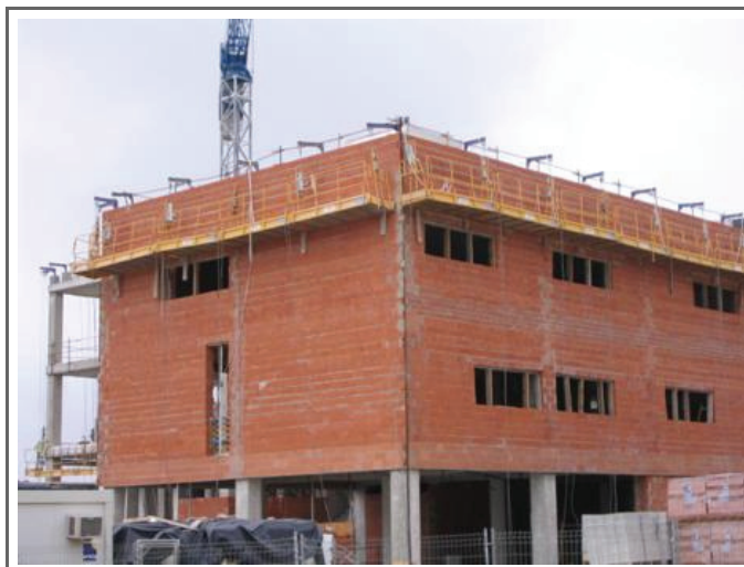
Longitudes de andamiada superiores a 8 m.
