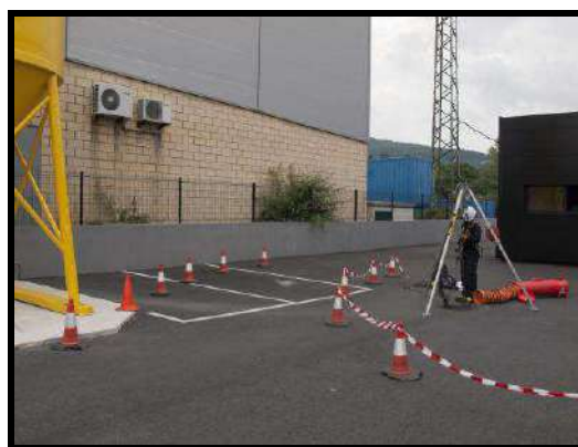
Control del tráfico en un parking mediante balizamiento
