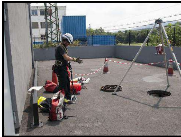
Entrada a un recinto confinado balizado y con el material lejos de la boca de entrada
